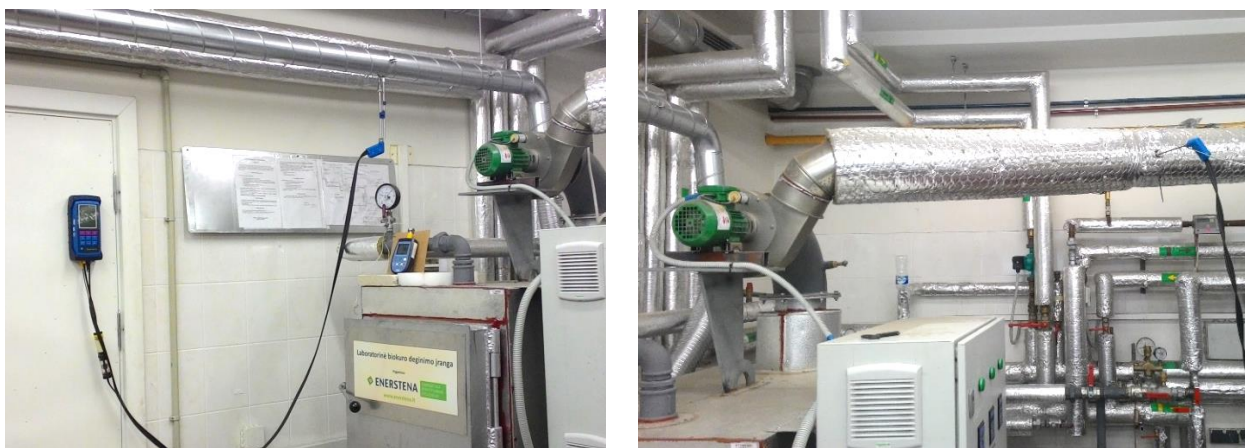
3.1.4 pav. Dūmų analizatoriaus matavimo taško vietos tyrimų metu. Kairėje pusėje – dūmų sudėties matavimas recirkuliaciniame kanale, dešinėje pusėje – iš katilo išeinančių dūmų sudėties matavimas.
