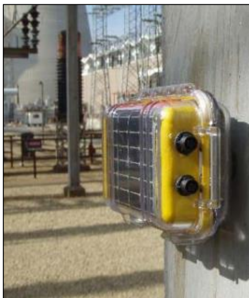
4 pav. Saulės energiją naudojantis jutiklis prijungtas prie transformatoriaus ir sekantis temperatūros duomenis
