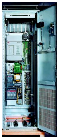
2.4.1 pav. ABB Unitrol statinės žadinimo sistema su valdymo įrenginiais [18]
