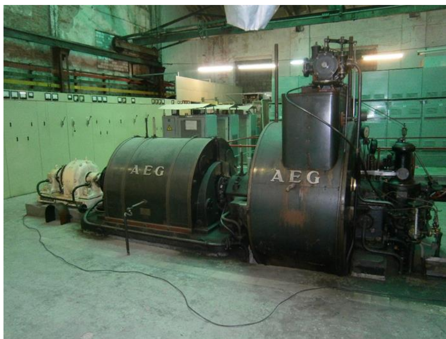
1.1 pav. Senoji 1,1 MW garo turbina, kuri buvo įrengta 1935m.
