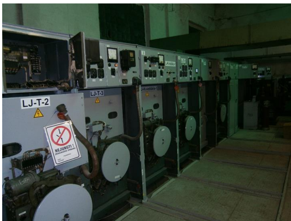
1.1 pav. Pagrindinė CPP – 61, 10 kV skirstykla
