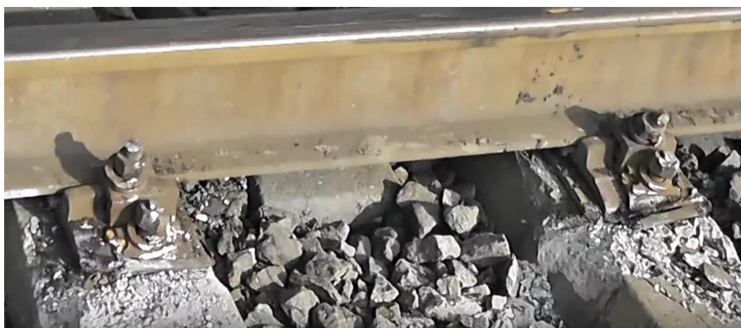
20 pav. Pabėgių ir tvirtinimo elementų pažeidimai
