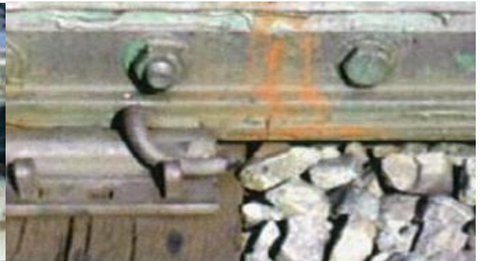
2.17 pav. Korozija izoliuotoje sandūroje [17]
