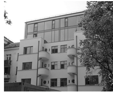
11 pav. nežinomo autoriaus nuotrauka, pastato Maironio g. 4 renovacija, fasadas iš vidinio kiemo
