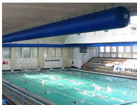
1.3.3 pav. Baseino ventiliacijos sistema
