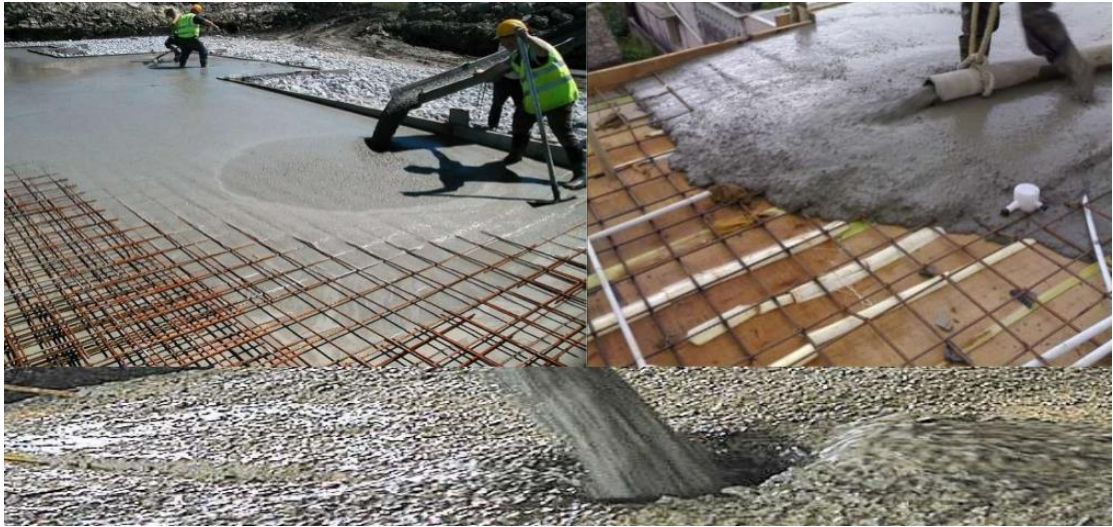
1.4 pav. Savaime susitankinantis betonas [39]
