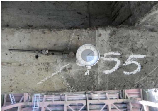
5.8 pav. Normalinio plyšio pločio pokyčio matavimas pirmojo tarpatramio perdangos penktos pagrindinės sijos viduryje, apatinėje lentynoje
