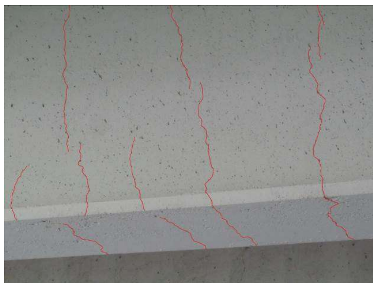
1.5pav. Plyšiai gelžbetoninėje perdangoje.
