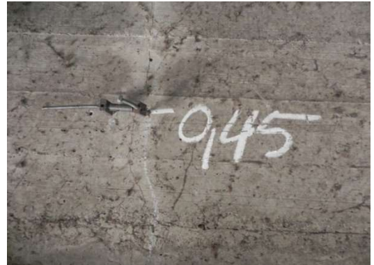
5.9 pav. Įstrižojo plyšio pločio pokyčio matavimas pirmojo tarpatramio perdangos ketvirtos pagrindinės sijos viduryje
