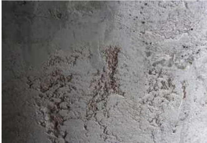
1.5 pav. Monolitinės betono konstrukcijos paviršiaus iškorėjimas (autoriaus nuotrauka)
