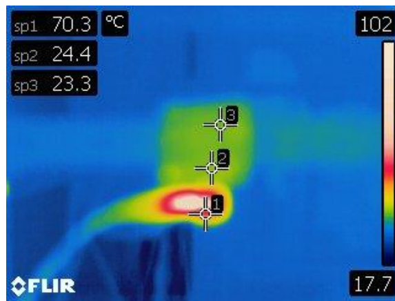
32 pav. Termovizoriaus rodmenys temperatūros generavimo metu
