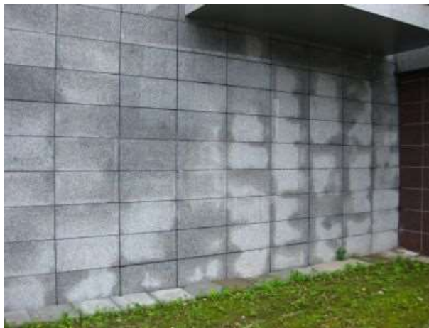
2.5.3 pav. Klinkerio defektai [14]
