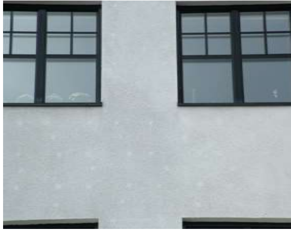
2.5.1 pav. Dėmių atsiradimas dėl termoizoliacijos tvirtinimo elementų
