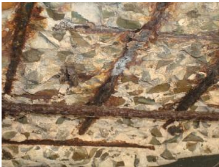
1.2 pav. Agresyvi aplinkos sąlygų paveikta armuota betoninė konstrukcija.
