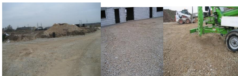
2.3 pav. Trupinto betono skaldos panaudojimas, laikiniems aikštelės keliams. Trupinto betono skaldos panaudojimas įrengiant pagrindus, prieš grindų liejimą.
