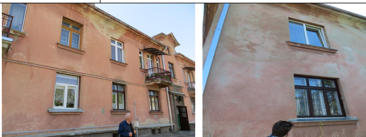
5 pav. Įdrėkusios sienos, kai kurios pastato konstrukcijos dalys aprupėję, po langais fasado spalva pakitusi
