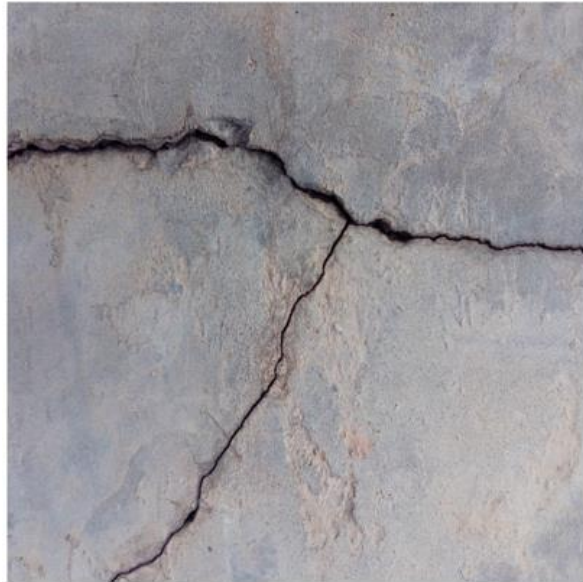
6 pav. Didelės raiškos betono su įtrūkimu pavyzdys
