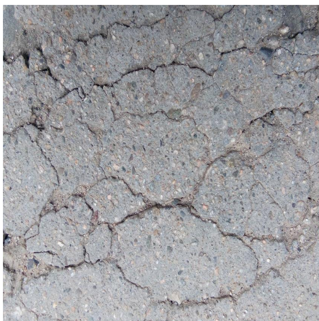
17 pav. Sutrupėjusio betono pavyzdys
