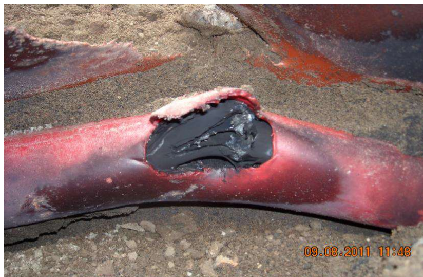
15 pav. Ekskavatoriaus pažeistas aukštosios įtampos kabelis [20]
