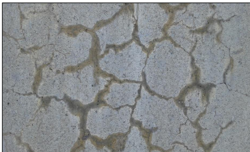
4 pav. Šarminio gelio išsiskyrimas į betono paviršių
