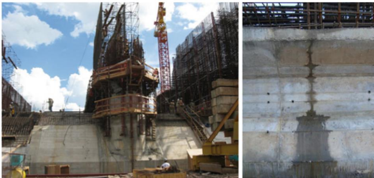
3 pav. Hidroelektrinės išsiliejimas ir konstrukcijos įtrūkimas dėl šiluminio poveikio, cemento hidratacijos metu
