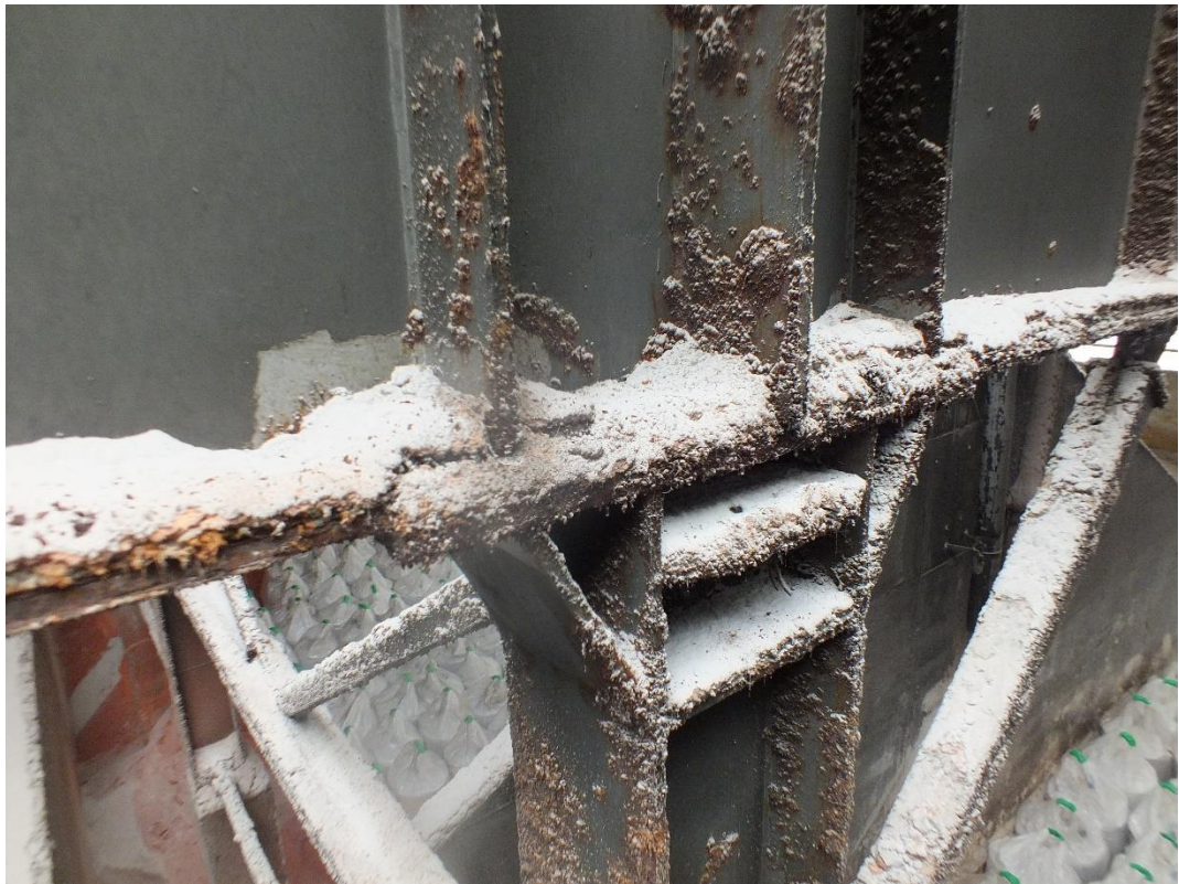
1 pav. Trašų sandėlio pažaidos sukeltos korozijos
