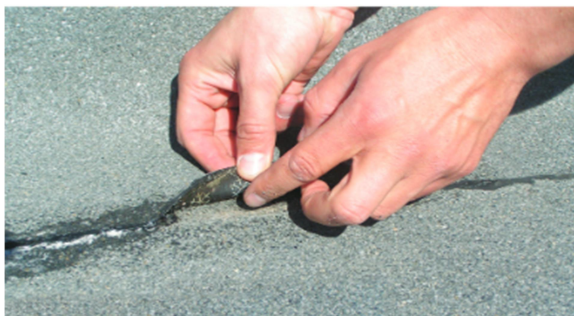
1 pav. Stogo dangos siūlės suirimas [10]
