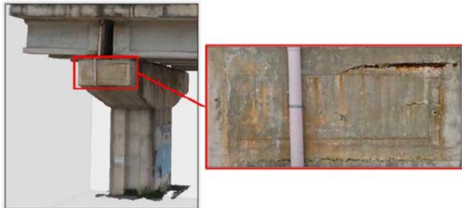
6 pav. Tilto atramos tiriamų defektų plotas [22].
