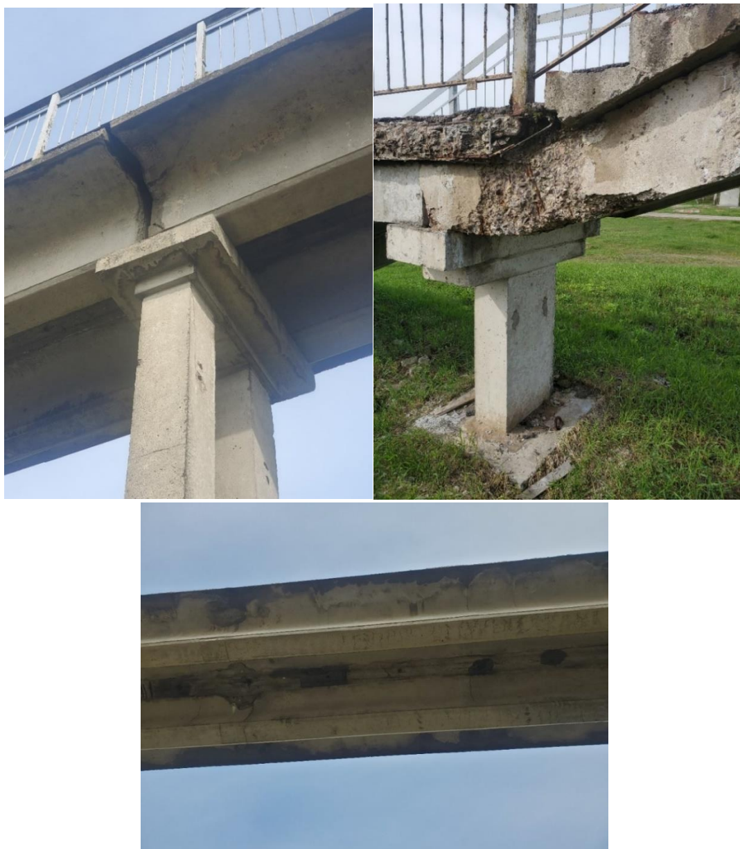
14 pav. Pirmojo tyrimo objekto konstrukcijų defektai
